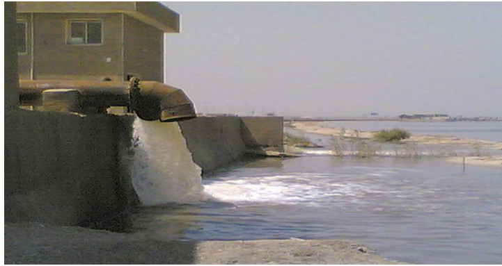
لوحة (8) نقل مياه الصرف إلى البحيرة
